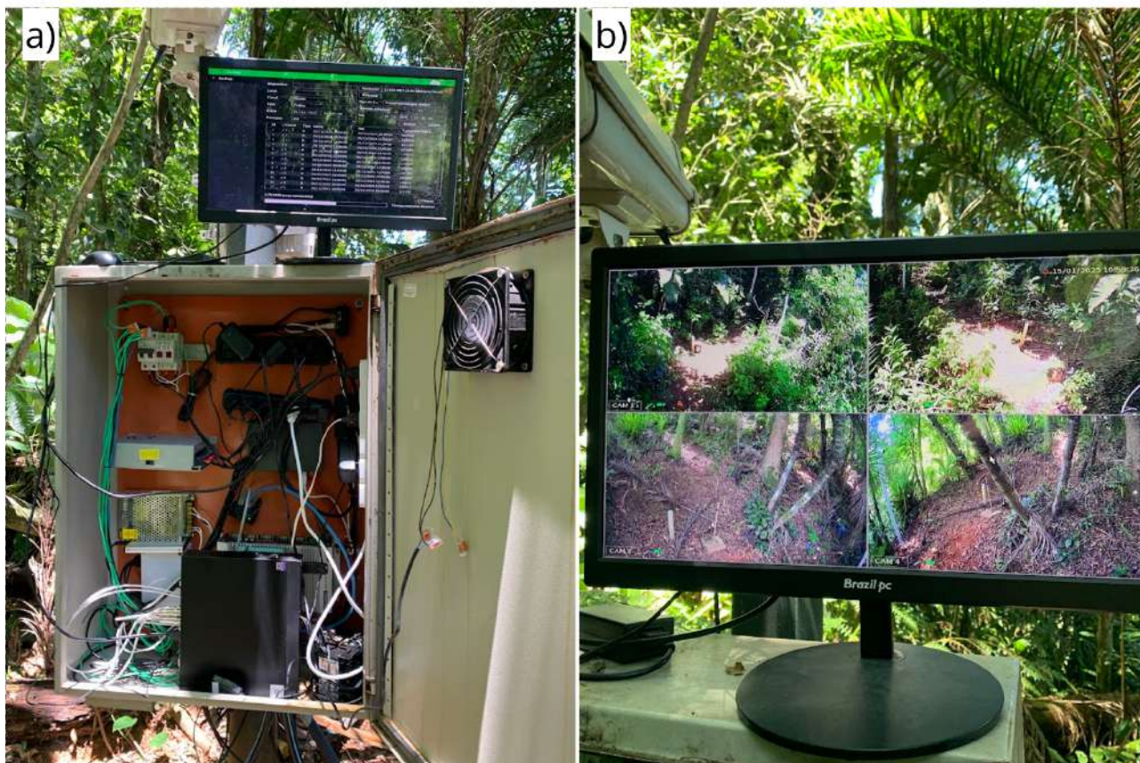
Figura 2 - Equipamento DVR em operação, a) Organização e DVR operacional após instalação, inserido em uma caixa de proteção localizada na encosta; b) visualização da operação dos quatro sensores.
