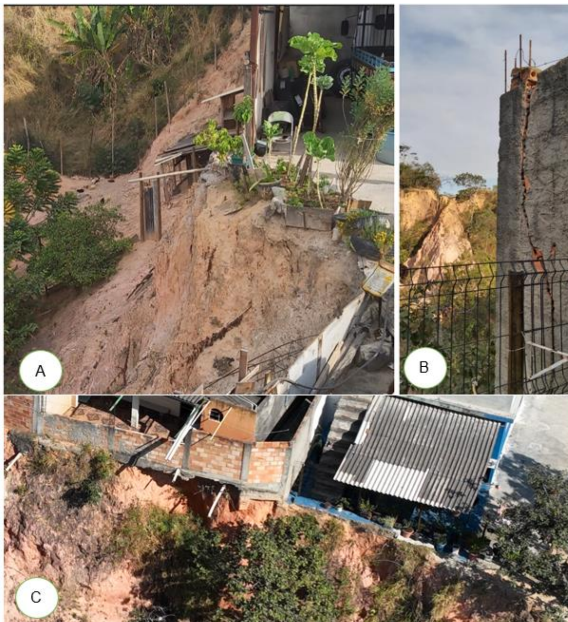
Figura 6 - Vistas Parciais da área de risco, evidenciando sua classificação em R4.
