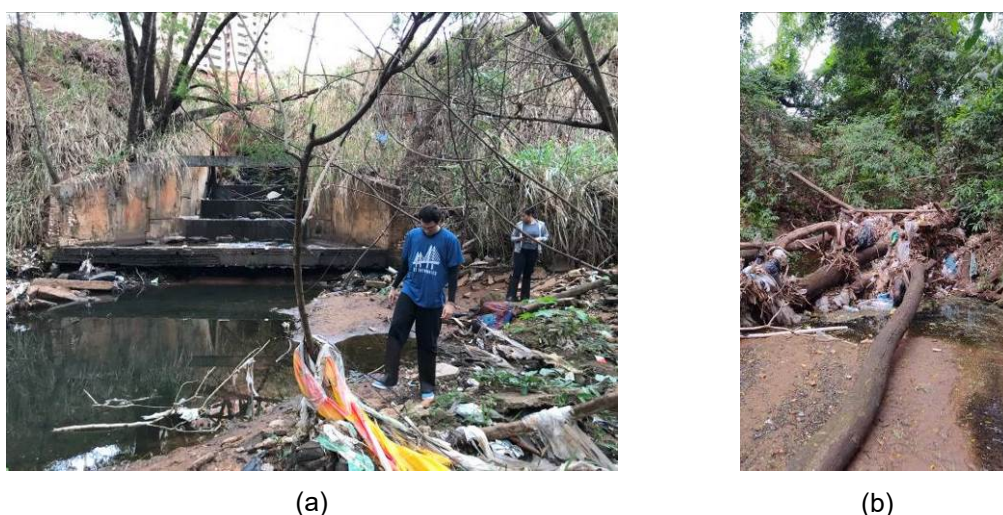
Figura 3. a) Escada hidráulica, construída acima do nível do lençol freático e presença de lixo urbano; b) Assoreamento do canal da feijão, com a presença de sedimentos e entulho.
