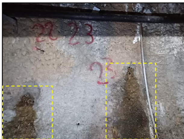
Figura 19. DHPs com vazão perceptível no trecho em NATM (fonte: ALTA Geotecnia, 2024).
