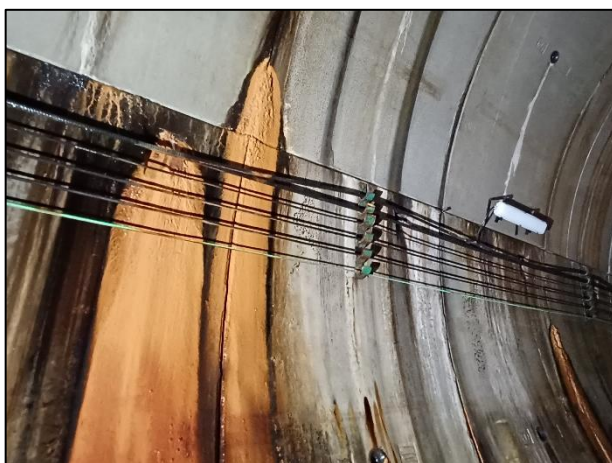
Figura 18. Novo ponto de infiltração e carreamento de sedimentos próximo a trecho onde foram realizadas injeções (fonte: ALTA Geotecnia, 2024).
