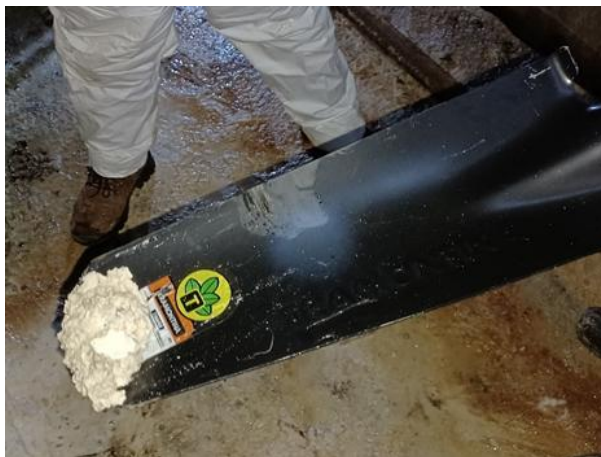
Figura 11. Material carregado pela percolação retirado no trecho em NATM para análise (fonte: ALTA Geotecnia, 2022).
