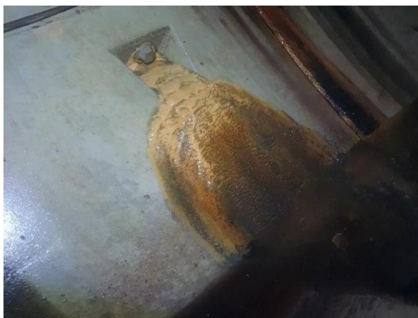
Figura 7. Percolação com carreamento de material, junto a aparafusamento da junta longitudinal (fonte: ALTA Geotecnia, 2022).
