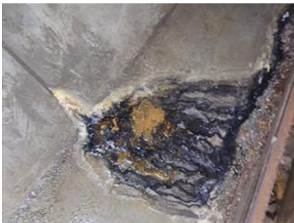
Figura 4. Material escuro carreado na base da parede esquerda, através da junta, sinalizando a presença de minerais máficos no substrato rochoso (fonte: ALTA Geotecnia, 2022).
