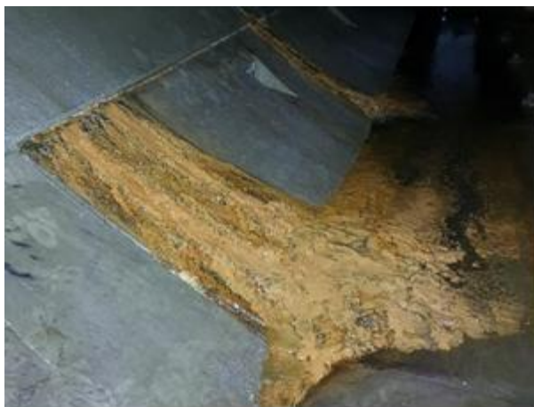
Figura 5. Percolação com carreamento de material de coloração laranja, junto à parede esquerda, base do túnel (fonte: ALTA Geotecnia, 2022).
