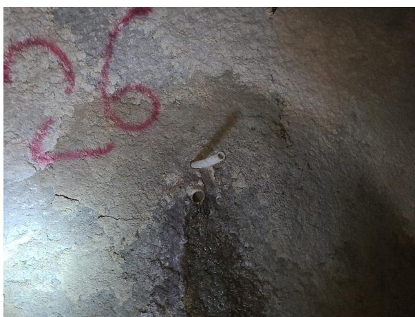
Figura 15. DHP instalado no trecho em NATM com fluxo perceptível de água (fonte: ALTA Geotecnia, 2023).
