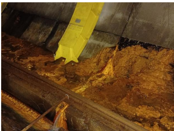
Figura 6. Destaque para a intensa infiltração com carreamento de finos de coloração alaranjada na parede, junto à base (fonte: ALTA Geotecnia, 2022).
