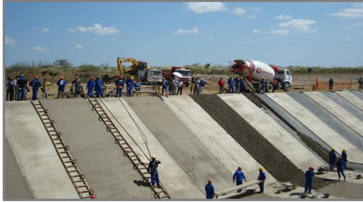
Figura 3. Construção do Canal da Transposição do Rio São Francisco. Fonte: A autora.
