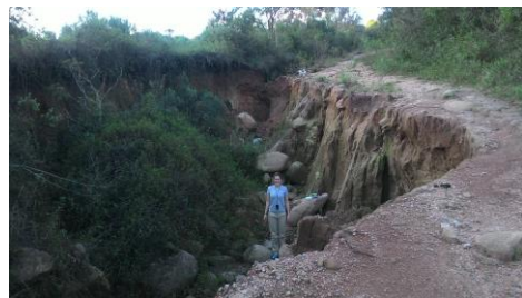
D) Ponto mais crítico da estrada – presença de voçorocas
