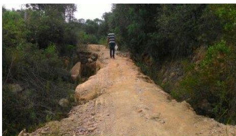
C) Resultado da falta de caneletas de drenagem
