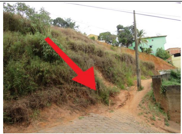
Figura 6 – Detalhe para o estrangulamento da rua Cid Gomes e para a posição do poste de energia, cuja posição foi alterada após ser atingido por movimentos de massa pretéritos. A seta retrata o eixo da direção principal dos movimentos gravitacionais de massa.
