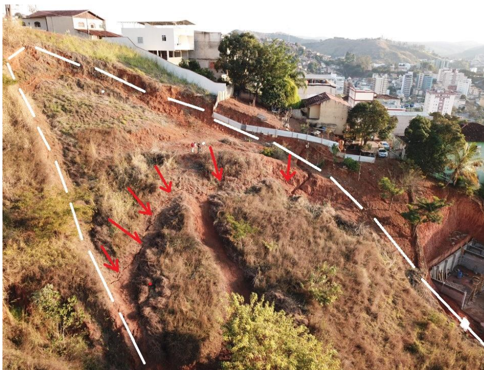
Figura 2 – Vista frontal da encosta, com detalhe para uma das superfícies de ruptura antigas (linha tracejada em branco), para as trincas no terreno recentes (setas em vermelho) e para a edificação em construção na base da encosta (trecho estável da encosta).
