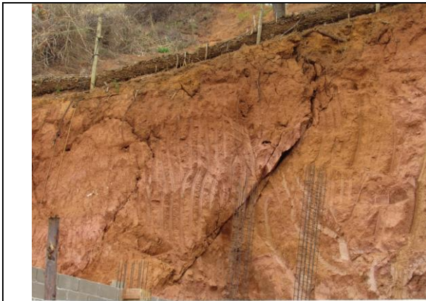
Figura 5 – Vista a partir da base da encosta no trecho com início de edificação em construção. Detalhe para uma superfície de ruptura antiga.
