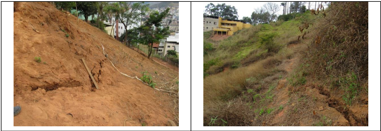
Figuras 3 e 4 – Vista parcial do terreno. Trincas recentes observadas.
