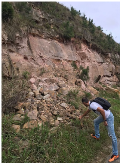
Figura 1. Vista geral do talude de corte demonstrando blocos e matacões provenientes de movimento de massa.
