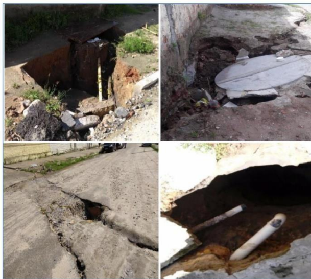
Figura 2. Surgimento de buracos e erosões. (CPRM, 2019)
