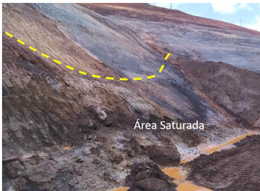
Figura 3. Ruptura de face causada pela saturação na região do pé do talude devido à condição de trapeamento de água.
