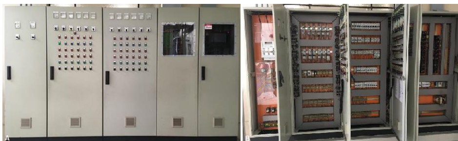
Figura 9 – Quadro elétrico de proteção e comando
