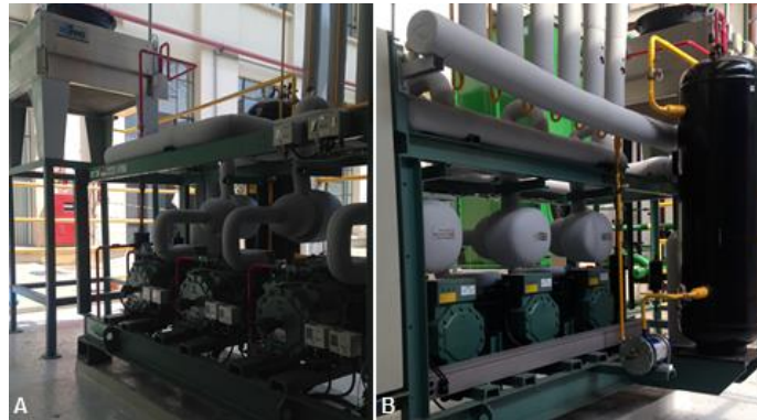
Figura 7 – Rack de congelados com condensador a ar remoto – (A) Vista frontal; (B) Vista posterior
