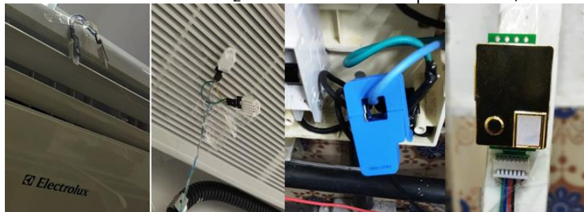
Figura 6 – a. Sensores de temperatura no insuflamento e no retorno. b. Sensor de corrente. c. Sensor de CO 2 instalado em suporte a 1,50 m do chão.
